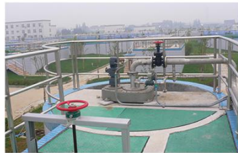
旋流沉砂器 Vortex Grit Chamber
